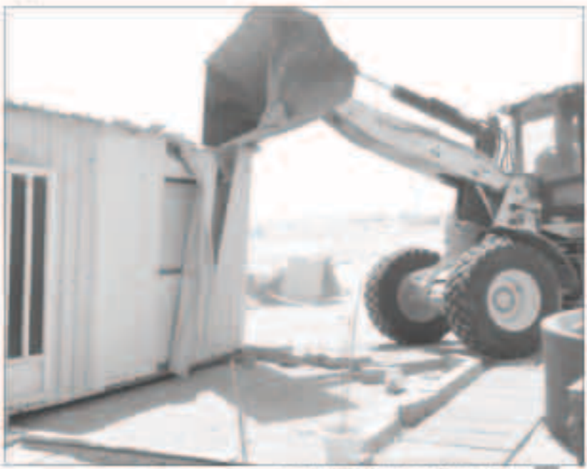
البلدية تزيل إحدى المنشآت غير المرخصة
