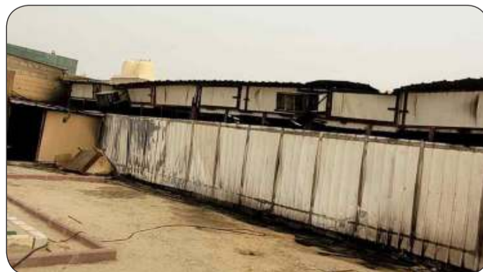
جانب من الحريق
