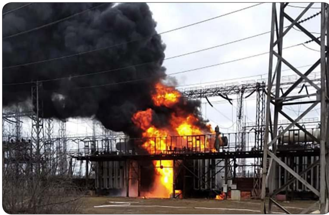
حريق في محطة لتوليد الكهرباء في أوكرانيا
